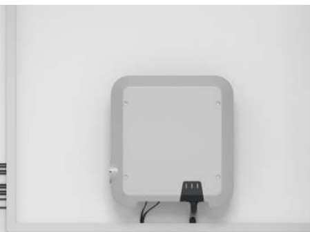
Der Solarwechselrichter eines Drittanbieters
